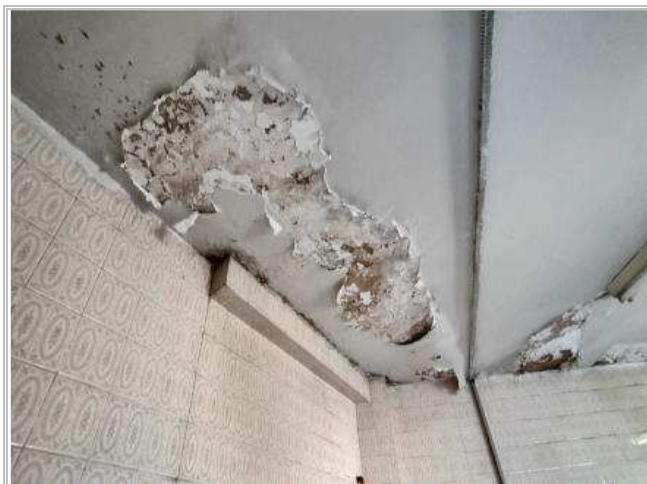
TETOS COM MARCAS DE INFILTRAÇÕES
