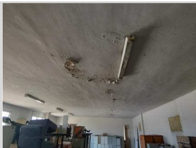
TETOS COM MARCAS DE INFILTRAÇÕES
